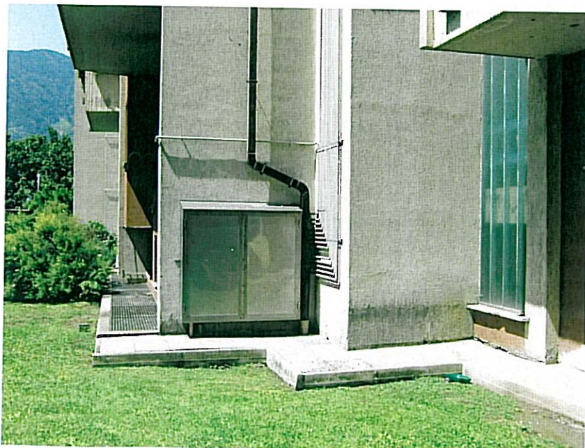
Gasverteiler mit Aufzugschacht Gasbox con vanos ascensore esterno
