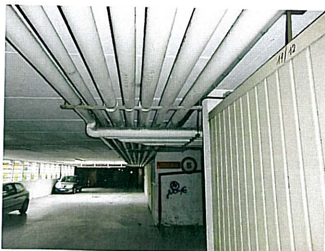
Tiefgarage mit Rohrleitungen Garage interrato con tubi di riscaldamento
