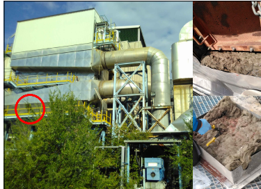
⑤ SONDAGGIO 5 FILTRO A MANICHE - LINEA 2
